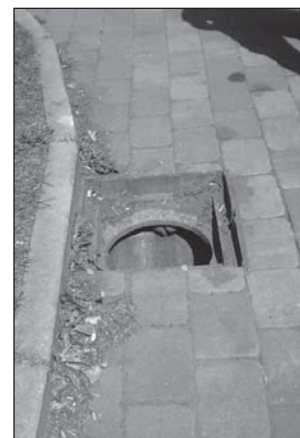
Frekventované chodníky jsou zdevastované. Jde o místa, kde se mohou pěší těžce zranit.
